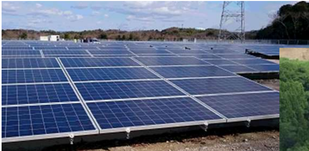
山陽小野田ソーラーパーク 2016年3月より稼働 建設場所：山口県山陽小野田市 発電規模：2,065 kW/h
