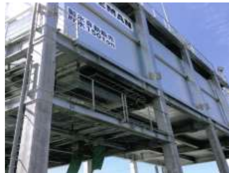
氷自動貯蔵搬出施設
