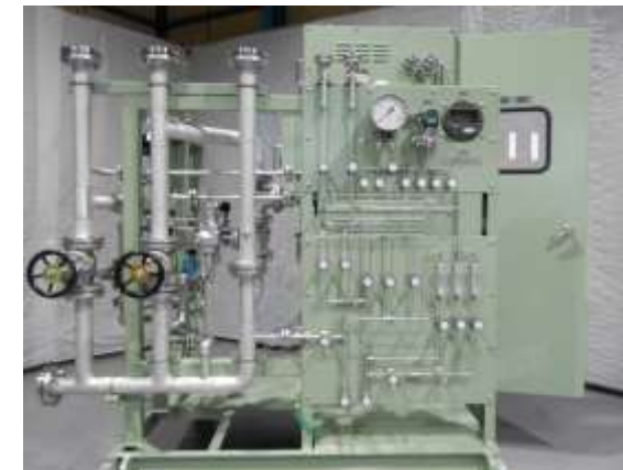
パッケージ型ガス制御装置
