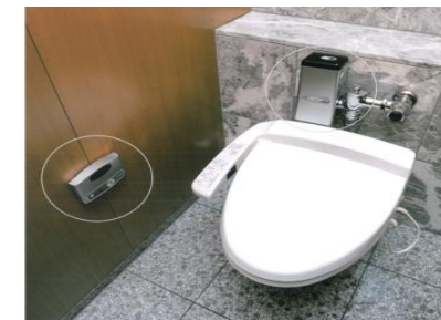
トイレ自動流水器
