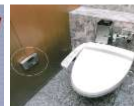
トイレ自動流水器
