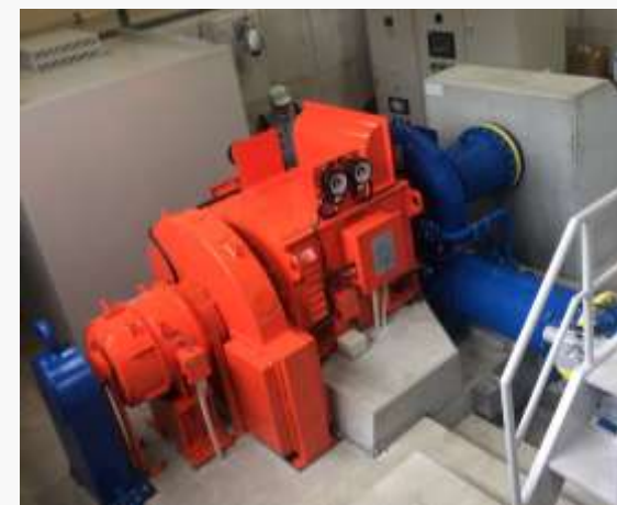
小型水力発電設備
