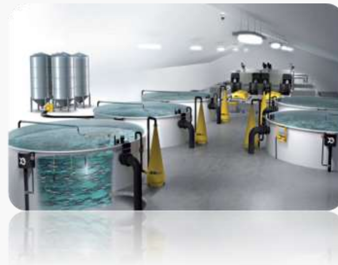
陸上養殖設備
