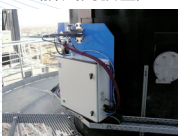
AMESA® (排気筒設置)
