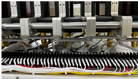
ヒーター配線 冷却ポンプ
